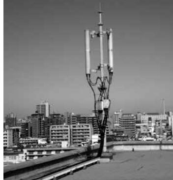
マンション屋上に設置された携帯電話基地局
